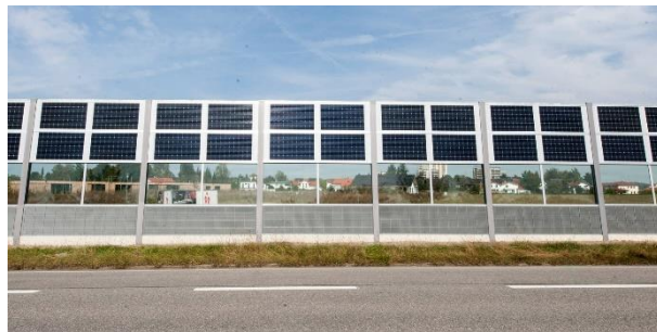
Abbildung 3: vertikal bifaziale PV-LSW, ©R. Kohlauer GmbH
