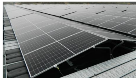
Abb.2: Mögliche Anwendung einer Floating PV-Anlage © Photo by Welser Profile GmbH
